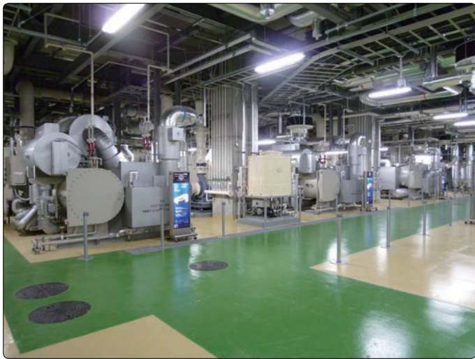
写真3 東京スカイツリー®地区熱供給施設 メインプラント内 (株東武エネルギーマネジメント提供)
