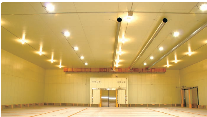
写真2 『パスカルエア』を用いた冷蔵倉庫内
